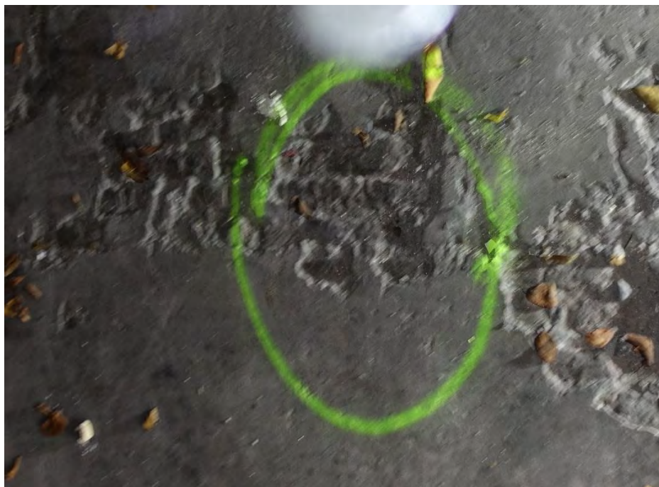
Afb. 122. Deel van de bij beschadiging van de smeervloer in het zicht gekomen bakstenen vloer. FH MAB 2025
