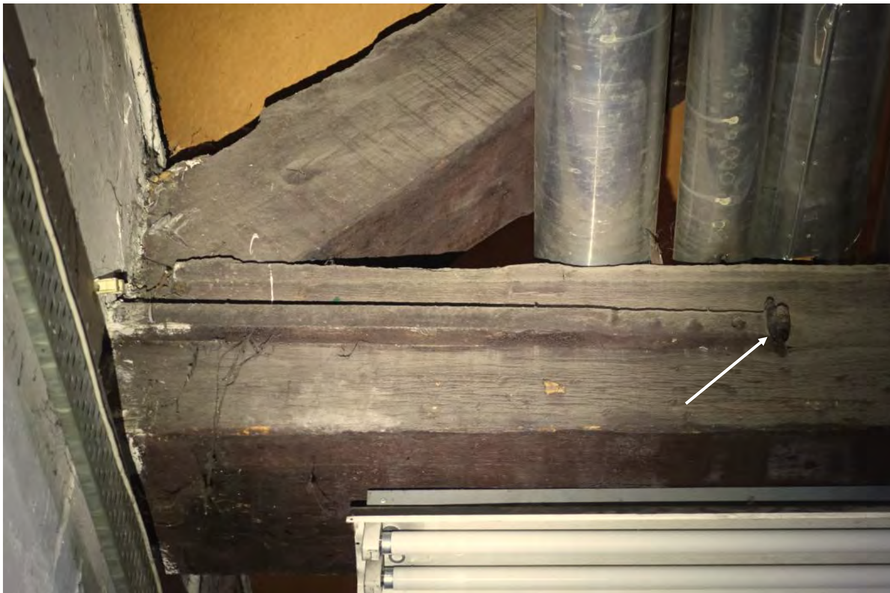
Afb. 95. Detail van een trekbalk met de verankering middels een zware ijzeren veer van het gevelanker. De veer is met vier nagels met de trekbalk verbonden terwijl het uiteinde is omgekruld en dit haakvormige einde is met een U-vormige nagel (witte pijl) in de balk verankerd. Deze constructie stamt uit 1827.
